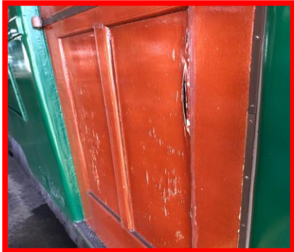
②木製扉の腐食
