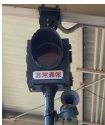
非常通報表示器
