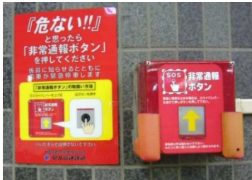
非常通報ボタン
