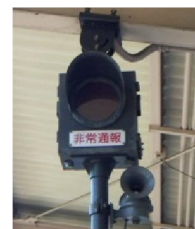
非常通報表示器
