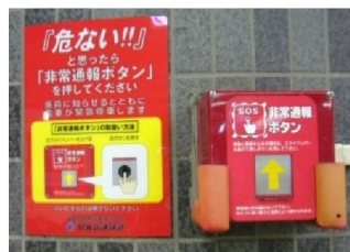
非常通報ボタン
