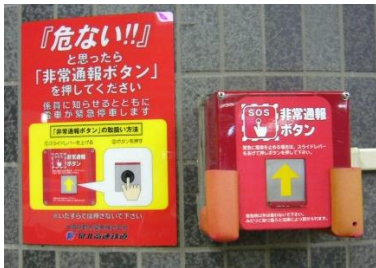
非常通報ボタン
