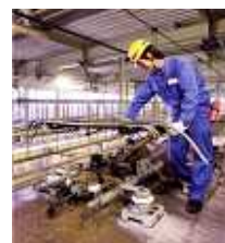
パンタグラフの点検
