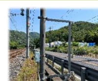
自動車転落警報装置 8箇所
