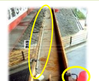
架道橋衝撃警報装置 2箇所
