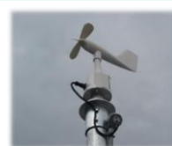
風速警報装置 14箇所
