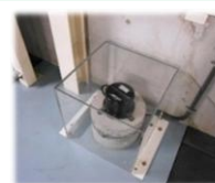
地震警報装置 8箇所
