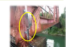
橋梁異状検知装置 2箇所
