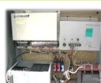
冠水警報装置 3箇所
