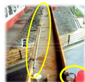
架道橋衝撃警報装置 2箇所
