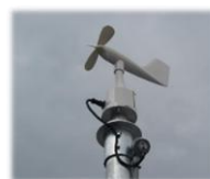
風速警報装置 14箇所
