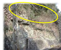
落石警報装置 17箇所
