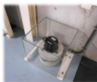
地震警報装置 8箇所
