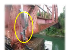
橋梁異状検知装置 2箇所
