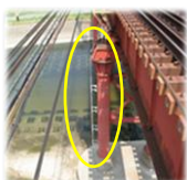
河川水位警報装置 17箇所
