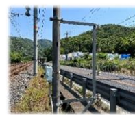
自動車転落警報装置 2箇所
