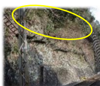
落石警報装置 17箇所
