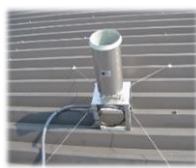
雨量警報装置 15箇所
