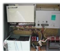
冠水警報装置 3箇所
