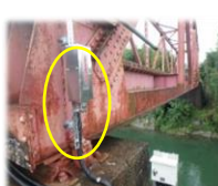
橋梁異状検知装置 4箇所
