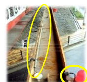
架道橋衝撃警報装置 2箇所
