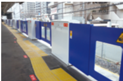
中百舌鳥駅の3番線・4番線ホームでホームドアの運用を開始
