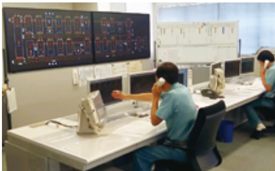
電力指令システムを全面更新
