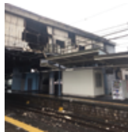
鎮火後の尾崎駅駅舎
