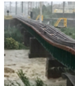
線路故障発生当時の男里川橋梁
