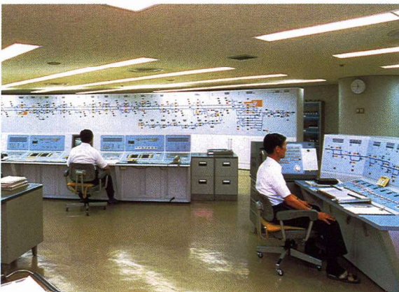
PTCが稼働する運転指令室
