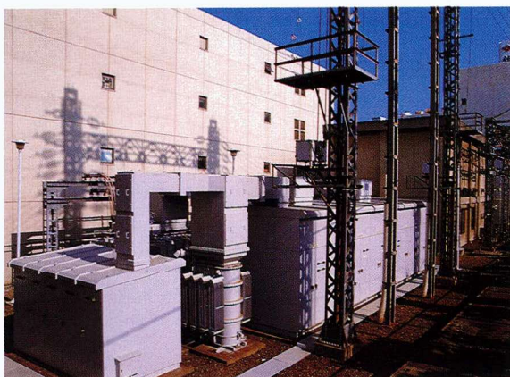
無人化された貝塚変電所
