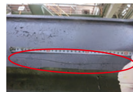
台車の亀裂発生場所
