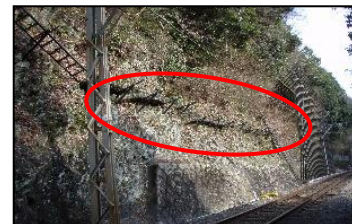
落石警報装置・17 警戒区域
