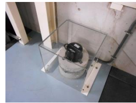
地震警報装置・7 か所
