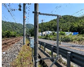
自動車転落警報装置・2 か所
