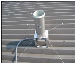
雨量警報装置 15 か所
