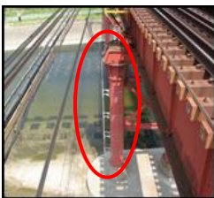
河川水位警報装置・17 か所
