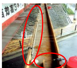
架道橋衝撃警報装置・2 か所
