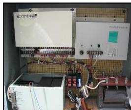
冠水警報装置・3 か所
