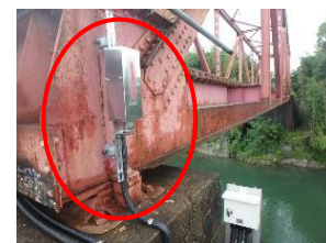
橋梁異状検知装置・3 か所
