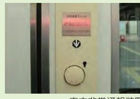
車内非常通報装置
