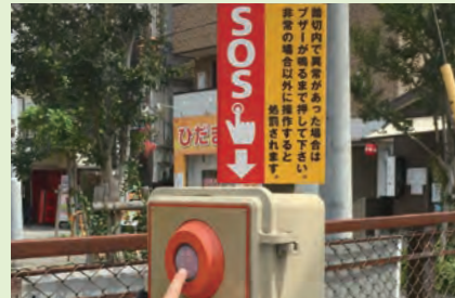
踏切の非常ボタン
