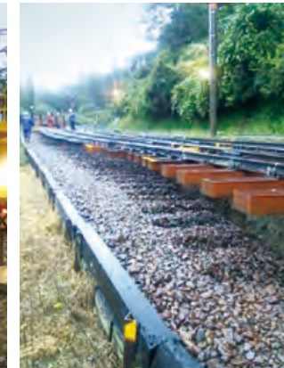
土砂流出が発生
