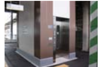
和歌山市駅のエレベーター
