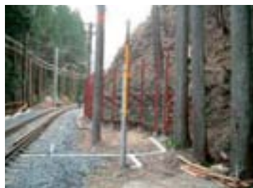
落石警報装置
