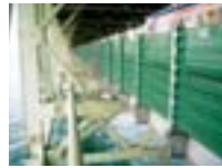
空港連絡橋防風柵 関西国際空港(株)提供
