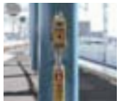
非常通報ボタン
