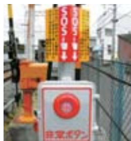
踏切支障報知装置
