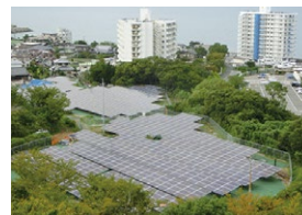
淡輪太陽光発電所
