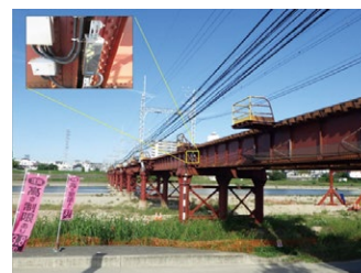
橋梁異状検知システム(高野線大和川橋梁)
