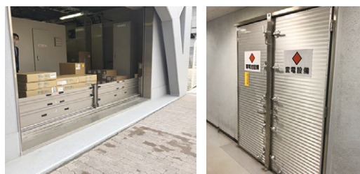
防潮堤(左)と止水扉(右)(玉出総合事務所)
