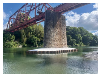
洗掘防止対策(高野線紀ノ川橋梁)
